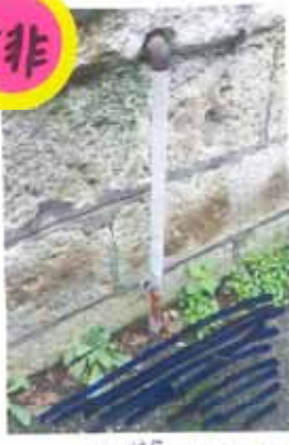
排水管が地面にささっています。
